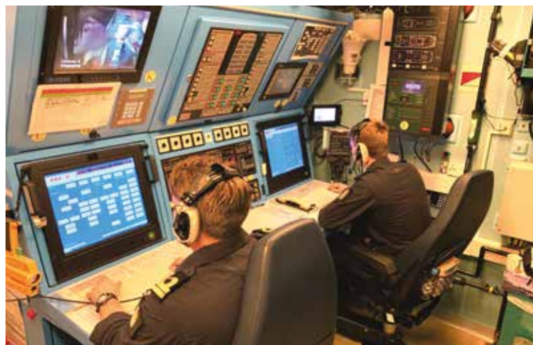
Herfra kontrollerer og overvåker maskinmesteren og hans crew alt i maskinrommet.
