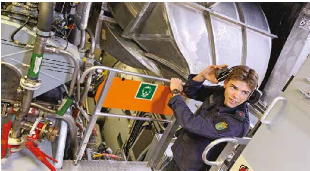
Vernepliktig maskinmester-assistent på sin kontroll-runde i maskinrommet. Målere leses av og det sjekkes blant annet for eventuelle lekkasjer.
